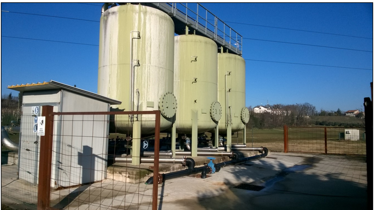
Figura 9.1 – Impianto di trattamento a carboni presso il campo pozzi "Zuccotti" di Castelnuovo d/G.
