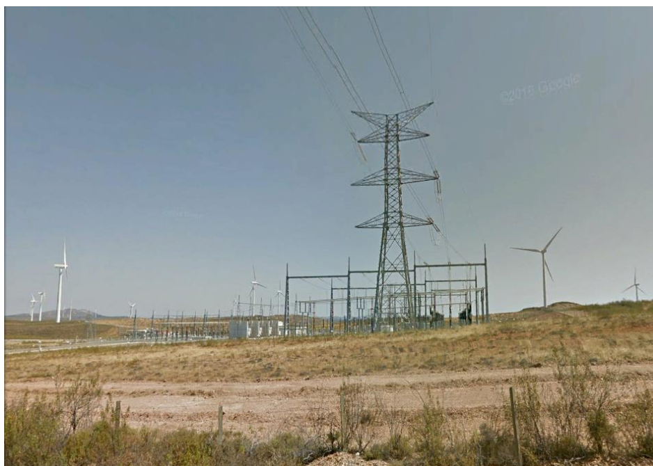
Subestación de la Puebla. (SET Puebla)
