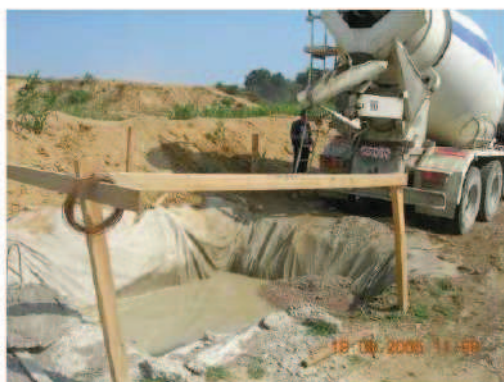
Figure 15 : Bassin de récupération des laitances de béton et de décantation des eaux de lavage des toupies
