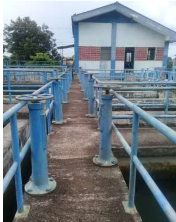
Foto 33. Planta de Tratamiento de Agua Potable, ENACAL Nueva Guinea
