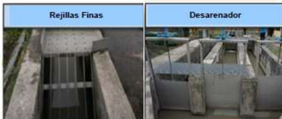
Foto 6. Ejemplo de un Sistema de Tratamiento Preliminar, PTAR Juigalpa
