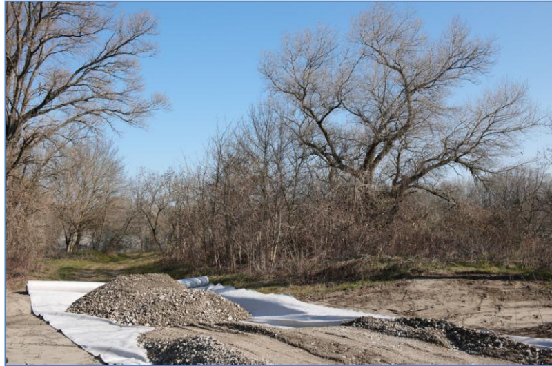
Piste provisoire en cours de réalisation avec pose de géotextile et apport de matériaux
