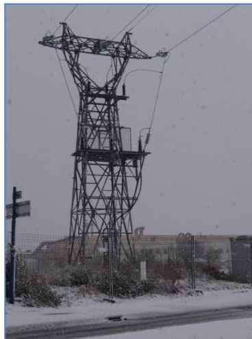
Pylône aéro-souterrain - Famille P1- 1 circuit 63 000 Volts
