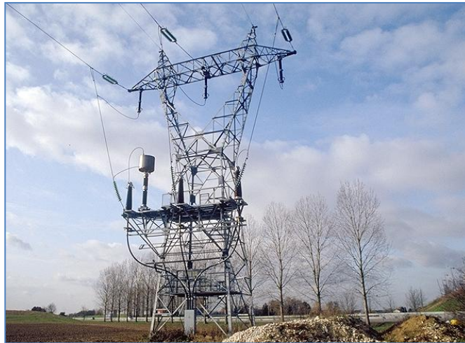
Pylône aéro-souterrain - Famille M1 - 1 circuit 225 000 volts
