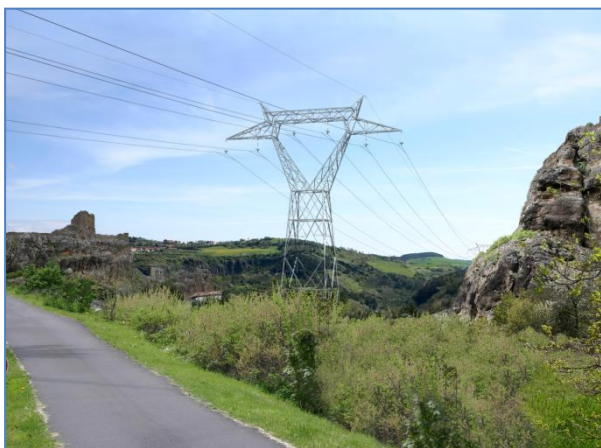
Pylône « Chat », Famille B1B3, 2 circuits Emprise au sol : 70 à 226 m 2 Envergure : 29 à 33 m Hauteur : 29 à 64 m
