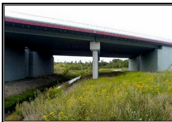
Fot. 5.22 Przykład przejścia dolnego zespolonego z ciekami dla zwierząt średnich (autostrada A-4, okolice Gliwic)
