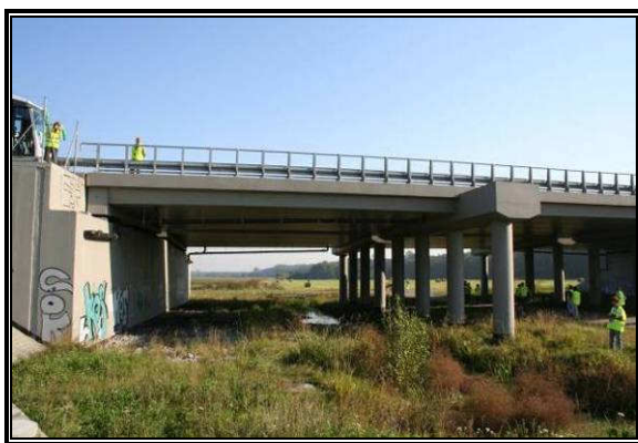
Fot. 5.21 Przykład przejścia dolnego dla zwierząt dużych (autostrada A2)
