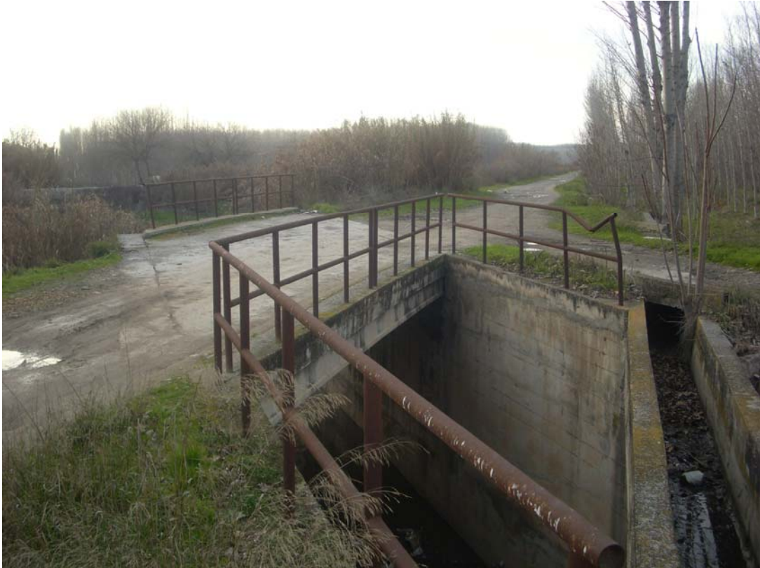
FOTO 9: PARTE FINAL PARALELISMO RÍO GENIL POR CARRIL A.A.A. Y CRUCE CON ARROYO JUNCARIL
