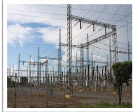
Foto No. 14.- SE Masaya, en la ciudad de Masaya. Sitio donde finaliza y entrega la LT La Virgen - Masaya
