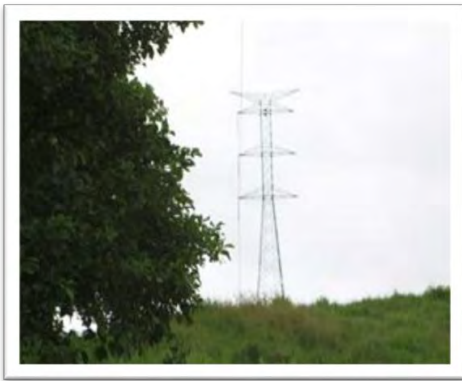
Foto No. 6.- Torre del SIEPAC donde se conectará la LT que viene de la SE La Virgen hacia Masaya
