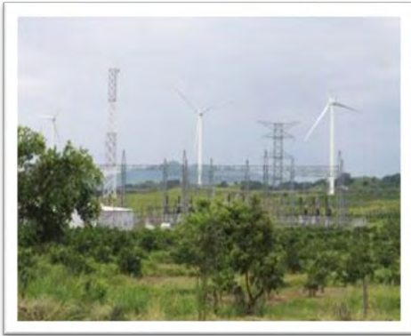
Foto No. 11.- Subestación Amayo, sobre la carretera Rivas – Peñas Blancas
