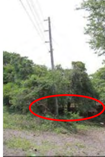
Foto No. 31.- Cercanía de poste de energía del área de riesgo de erosión, nótase la inclinación que posee.
