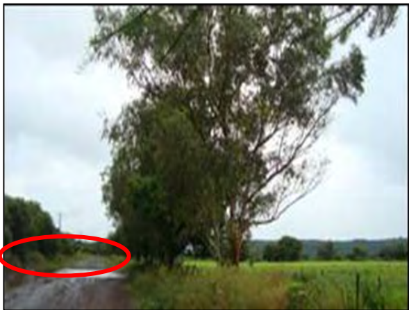
Foto No. 27.- Condiciones de encharcamiento de la vía por problemas de drenaje y pendiente mínima de la zona.
