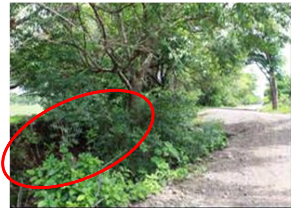
Foto No. 30.- Vista desde la carretera del mismo cauce con su proceso erosivo.
