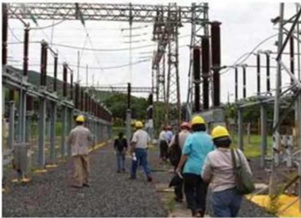
Foto No. 1.- Subestación Planta Momotombo
