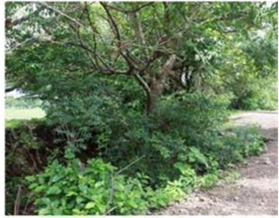
Foto No. 10.-Condiciones en el tercer tramo de la línea, en donde pasa tangencial a la carretera el cauce El Obraje con serios problemas de erosión de taludes
