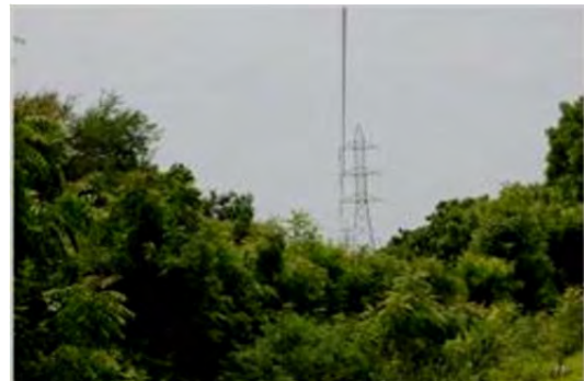
Foto No. 4.- Otra toma de LT en Planta Momotombo. Obsérvese diferencia de altura en la vegetación en el derecho de vía.
