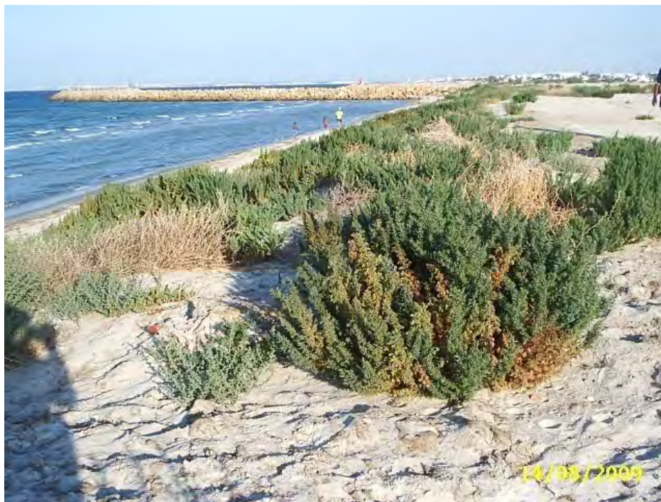
Photo 5 : Remblayage au sud du port d'abri d'Oued Hamdoun (Talus occupée par Suaeda sp et Salsola kali )
