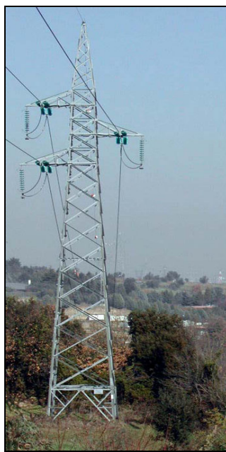
Foto 2) – Sostegno a traliccio troncopiramidale
