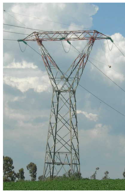
Foto 3) – Sostegno a traliccio delta rovescio
