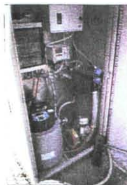
STAZIONE DI QUALITÀ CON ALLERTAMENTO E TELETRASMISSIONE T. SETTA A VALLE DEL CANTIERE DI BADIA NUOVA
