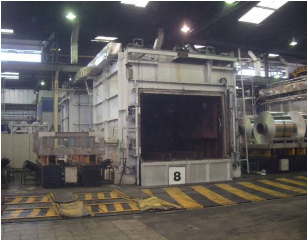
Εικόνα : Άποψη φούρνου ανόπτησης
