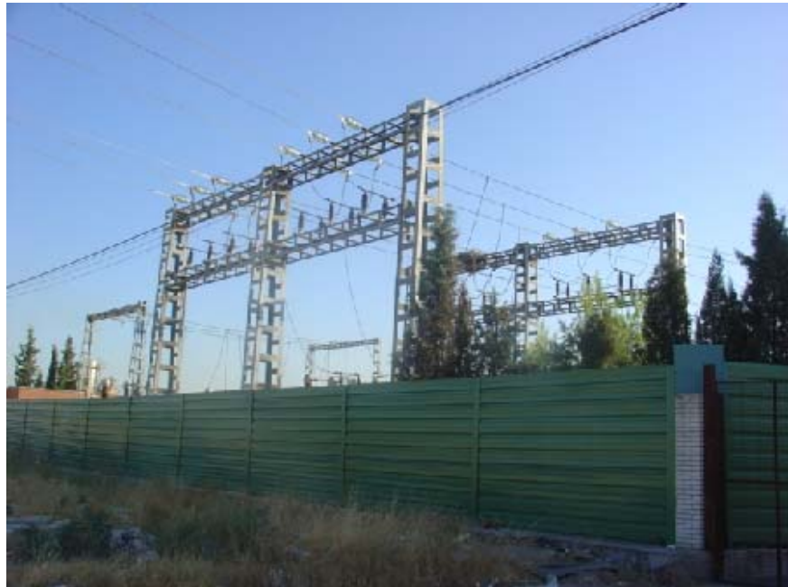
VISTA DE LA ACTUAL SUBESTACION
