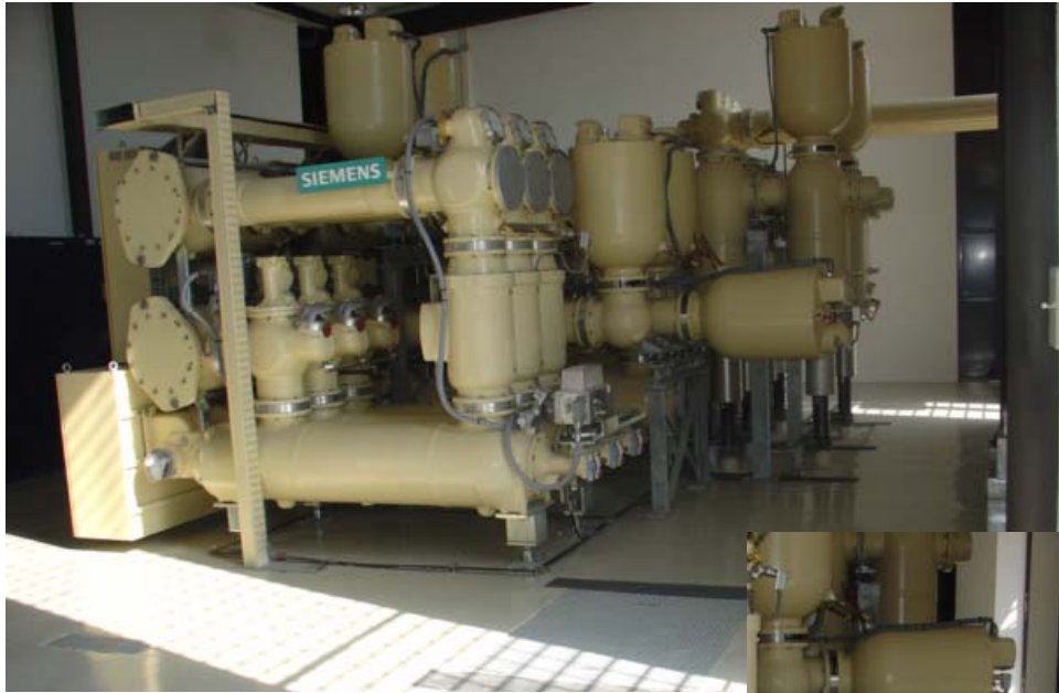
Parque de 220 kV
