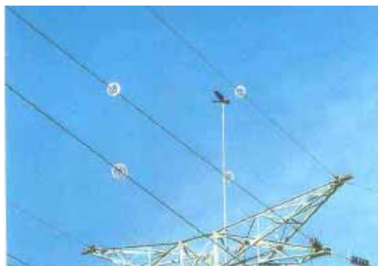
Ligne équipée de spirale
