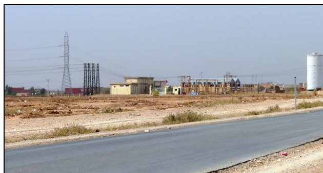
Photo 1 : poste de Fquih Ben Saleh
