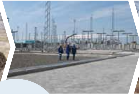
Interconector de Caprivi na Namíbia: um nó de distribuição regional de eletricidade (2005)
